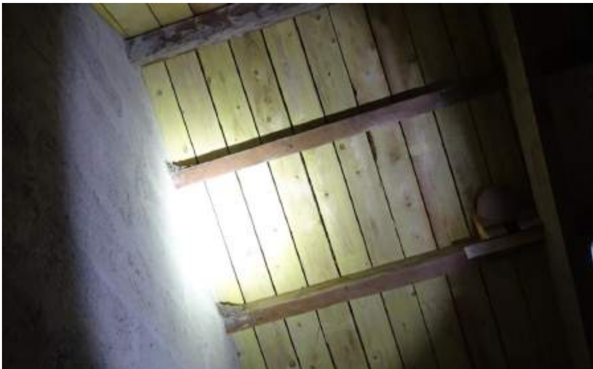
Figure 13: départ de nids dans les combles côté PROPICE
