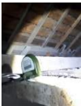
Photo 4: Micro installé dans le comble à étudier
