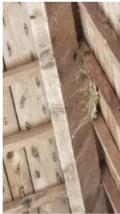
Photo 6: Nid de moineau construit sur la poutre de faitage
